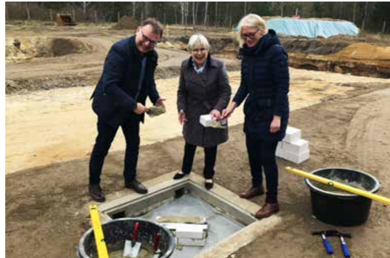
Symbolische Grundsteinlegung durch die Beigeordnete Birgit Weber, Siglinde Rauch-Liebich vom Sächsischen Staatsministerium für Wirtschaft, Arbeit und Verkehr und den Bürgermeister Heiko Driesnack.
